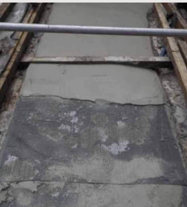
Bild 7: Darstellung des lagenweisen Aufbaus der textilbewehrten Rissbandage.
