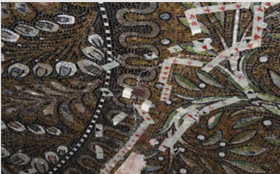
Bild 1: Risse in den wertvollen Deckenmosaiken des Aachener Doms.
