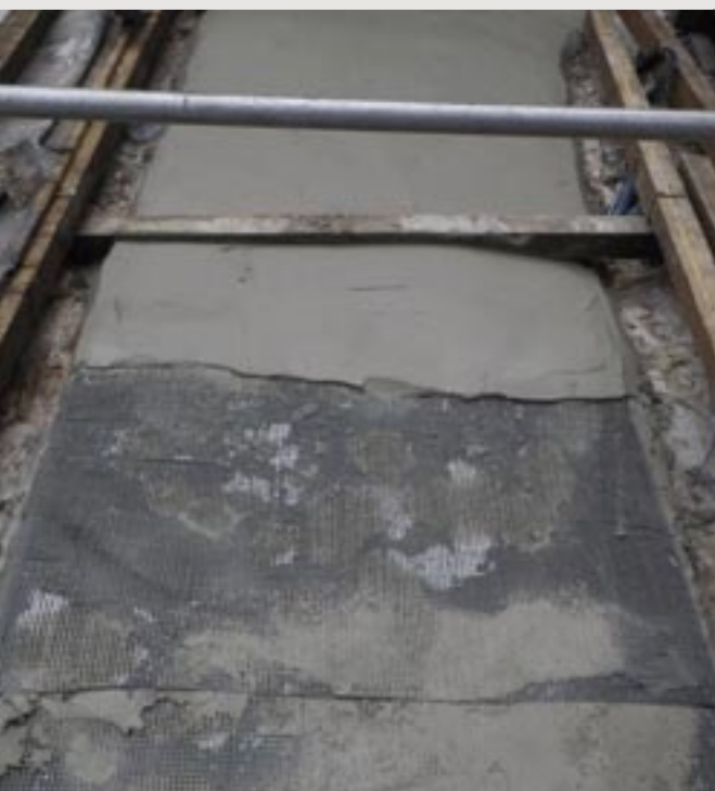
Bild 7: Darstellung des lagenweisen Aufbaus der textilbewehrten Rissbandage.
