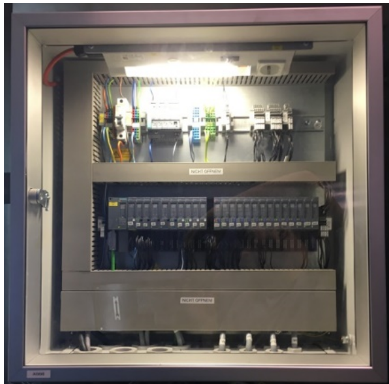
Abb. 3.9: Schaltschrank der WEA Automatisierung in der Gondel mit Peripheriemodul
