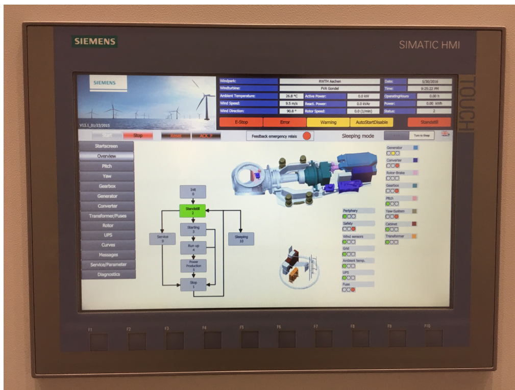
Abb. 3.16: Übersichtsseite der Benutzeroberfläche der WEA Steuerung auf einem Siemens HMI im Schaltschrank im Prüffeld
