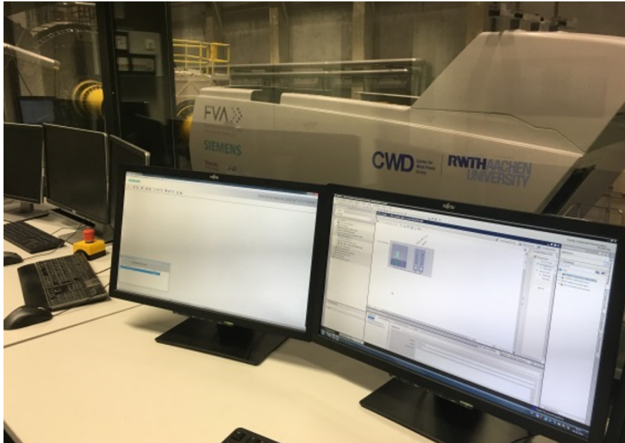
Abb. 3.15: Projektierungs- und Bedienrechner sowohl für die Forschungswindenergieanlage als auch das HIL System in der Leitwarte des Systemprüfstandes am CWD der RWTH Aachen mit Blick über das Prüffeld
