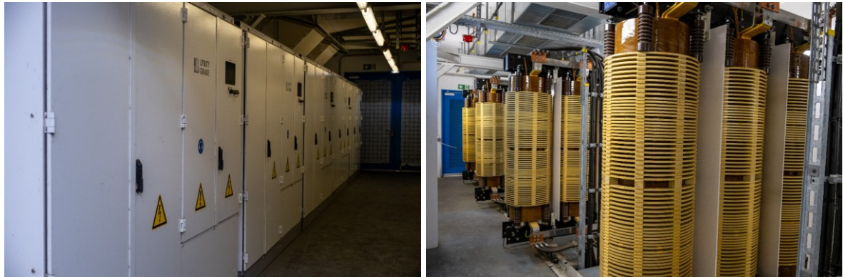
Abbildung A.11: links: Umrichter des Batteriespeichers M5BAT; rechts: Transformatoren des Batteriespeichers M5BAT
