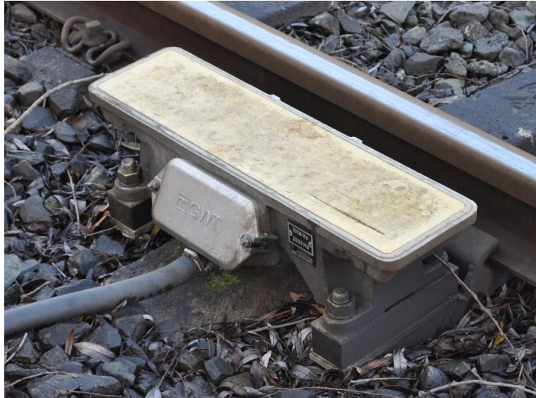
Abbildung 37: Punktförmige Zugbeeinflussung (PZB-Gleismagnet) neben der Schiene.
