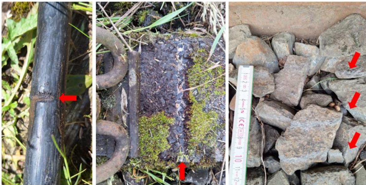
Abbildung 27: Links: Schnitt im Schutzmantel des Kabels, Mitte: abgetragenes Moos auf Betonschwelle. Rechts: Spuren des Druckwasserstrahls auf Schottersteinen.
