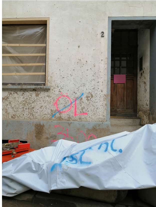
■ Abb. 6.3 Kennzeichnung von potentieller Ölkontamination an einem betroffenen Wohngebäude. (Foto: Harish Selvam, 18.08.2021)
