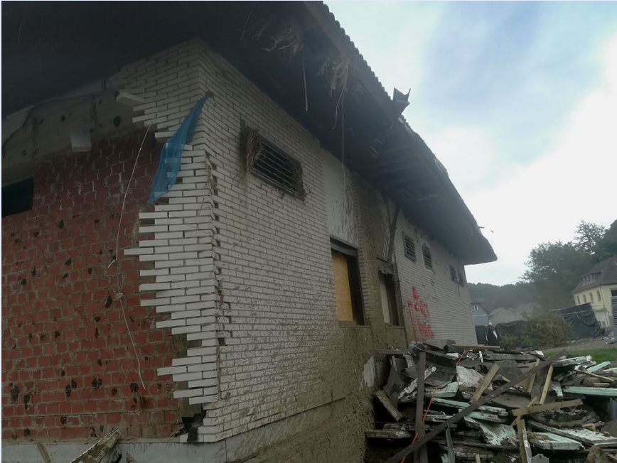
■ Abb. 6.2 Abgelöste Verklinkerung an einer Hauswand gibt Hinweise auf hohe hydraulische Einwirkungen während des Hochwassers. (Foto: Stefanie Stenger-Wolf, 18.08.2021)
