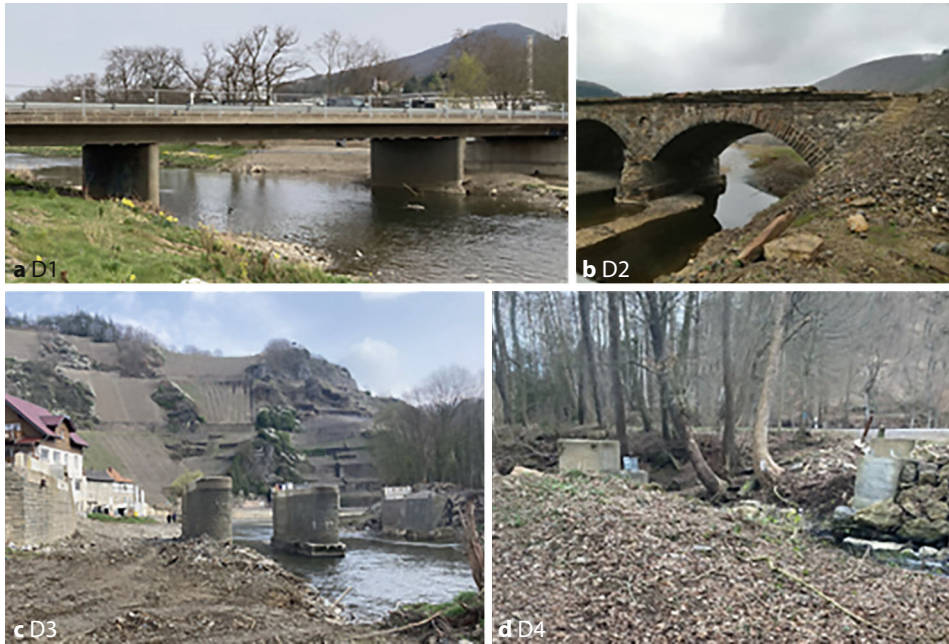
Abb. 10.1 Beispielhafte Darstellung der Schadensmerkmale an Brücken nach dem Hochwasser 2021 an der Ahr. a Verlust des Geländers, b Verlust von Zufahrtsrampen, c Verlust des Überbaus, d vollständiger Abriss (a, c Burghardt et al. 2024; b, d eigene Abbildung)
