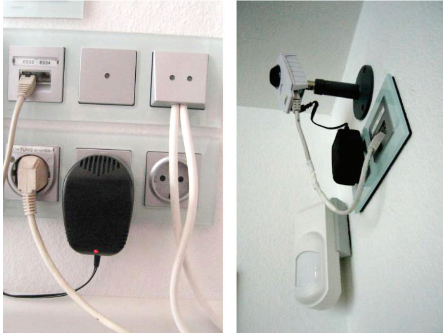
Abbildung 5: Redundante Installationen und Kabelchaos in einem sog. intelligenten Gebäude. Am Beispiel des T-Com-Hauses in Berlin, 2005.
