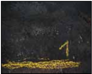
Abb. 6.34 Schutzschicht Zone 1, Ofenwand schmelze- frei nach 1. Abguss
