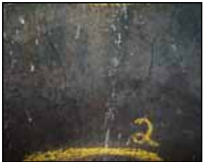
Abb. 6.35 Schutzschicht Zone 2, Ofenwand schmelze- frei nach 2. Abguss
