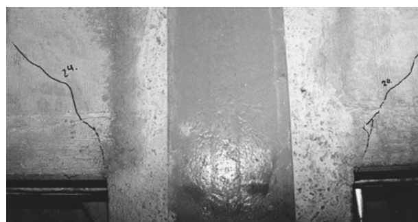
Bild 2.27: Diagonalrisse an der Oberseite der Randplatten /Bod00/
