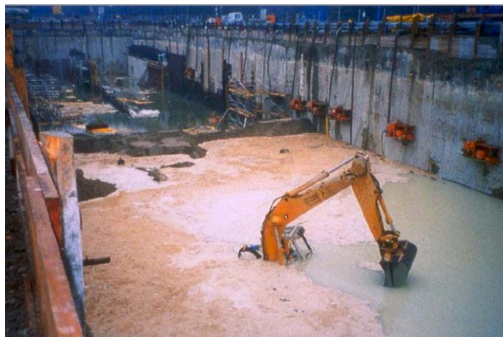
Abbildung 1.2: Hydraulischer Grundbruch in der Baugrube (Mittag 2009)
