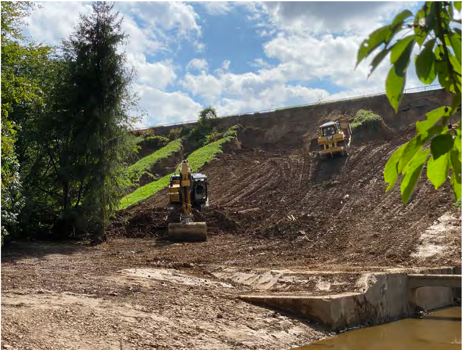
Bild 1: Landseite der Steinbachtalsperre im Raum Euskirchen nach dem Hochwasser im Juli 2021 Foto: Holger Schüttertrumpf
