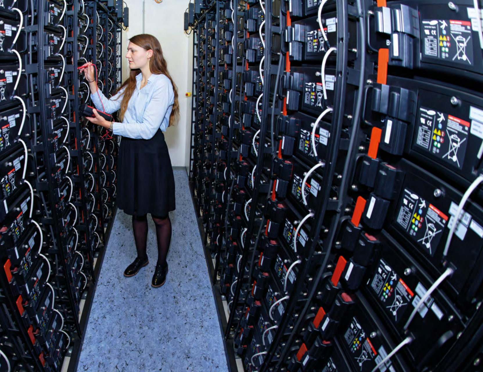
Bild 1: Blick in den Lithium-Ionen-Batterieraum des Großspeichers M5Bat Foto: Peter Winandy
