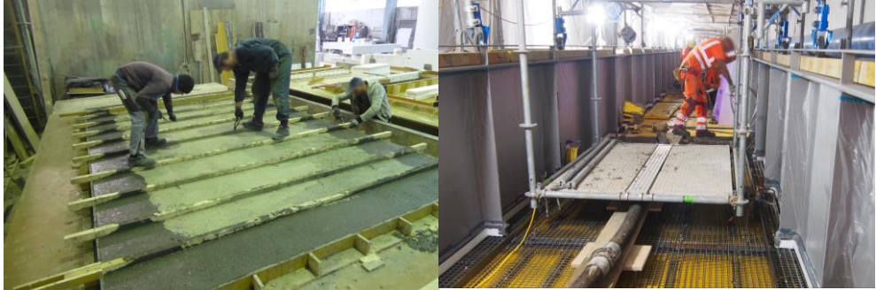
Bild 8 Betreten von biegeweichen Latten bei der Produktion von Deckplatten prägt Lageabweichungen der nichtmetallischen Bewehrung ein (links, Foto: Jan Bielak); Schwebende Bühne und punktgestützte Trittplattformen beim Rheinsteg Albbruck (rechts, Foto: Jan Bielak)
