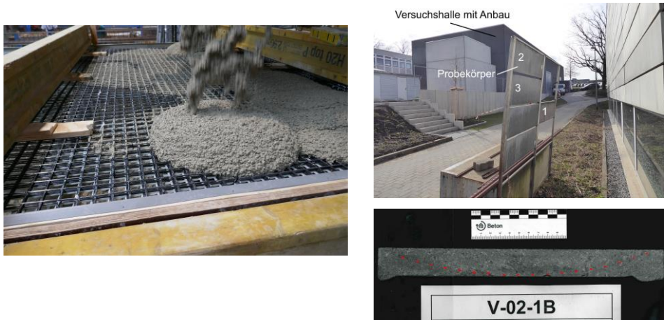
Bild 9 Unzureichende Fließfähigkeit des Betons drückt obere Bewehrungslage herunter (links, Foto: Philipp Cornelissen); zentrische Bewehrungslage bei Probekörpern für Qualitätsüberwachung von Fassadenelementen nach 10 Jahren verfehlt (rechts, Foto: Jan Bielak)
