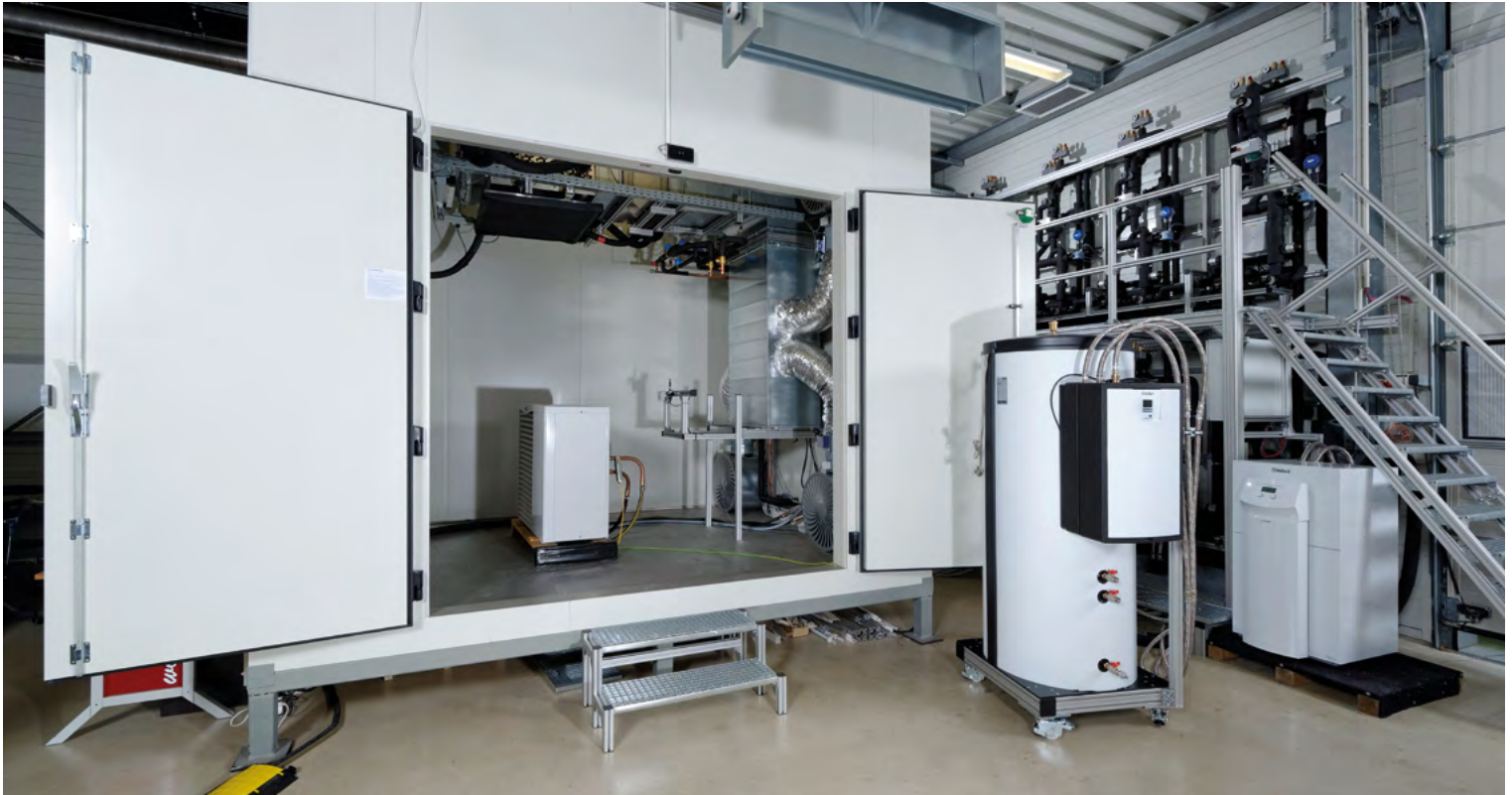
Bild 1: Aufbau eines Hardware-in-the-Loop-Prüfstands mit Klimakammer und Hydraulikstation zur Vermessung von Wärmepumpen unter dynamischen Betriebsbedingungen Foto: Lehrstuhl für Gebäude- und Raumklimatechnik
