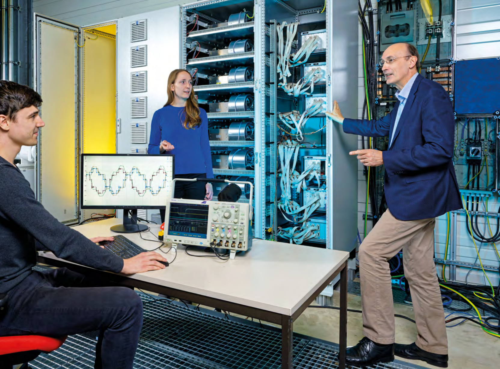
Bild 1: DC-DC-Leistungswandler, entwickelt am Institute for Power Generation and Storage Systems des E.ON Energy Research Centers, werden in Betrieb genommen. Sie erlauben flexible Betriebsstrategien für vielfältige Anwendungsfälle in DC-Netzen. Foto: Peter Winandy
