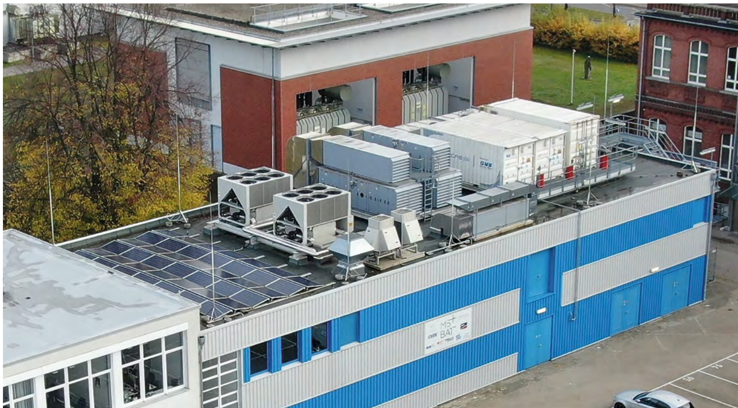
Bild 2: M5Bat-Batteriegrö  speicher der RWTH Aachen neben dem Umspannwerk der Stadtwerke Aachen AG, kurz STAWAG, H  ttenstra  e 9.
