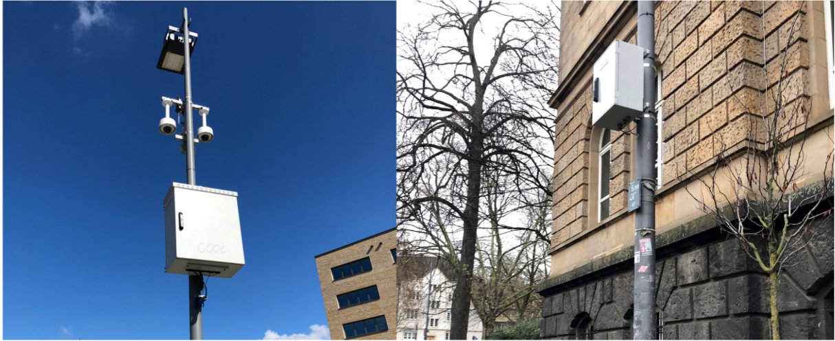
Abbildung 11 Funktional gestaltete technische Infrastrukturen in Aachen Eigene Fotos
