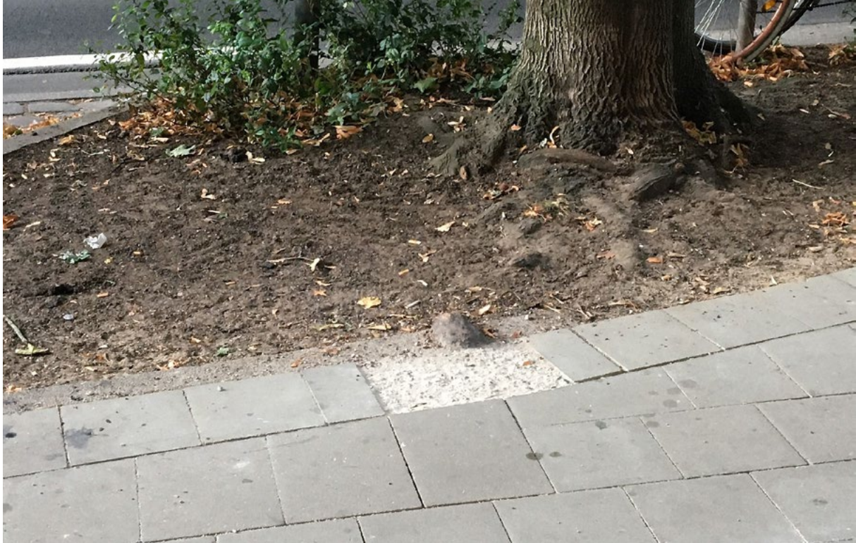
Abbildung 3: Nicht gepflasterte Stelle im neuen Gehweg. Quelle: Christine Neubert.
